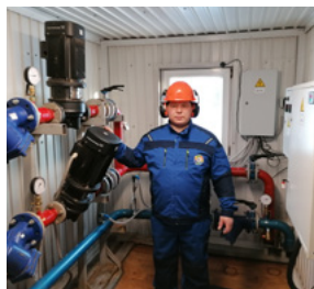
Дизельная электростанция деревни Согом ХМАО-Югры
