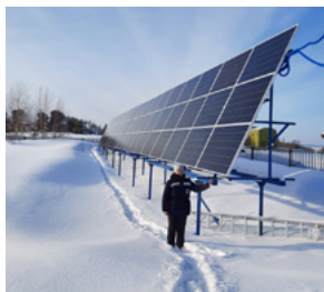
Дизель-солнечная электростанция деревни Никулкина ХМАО-Югры
