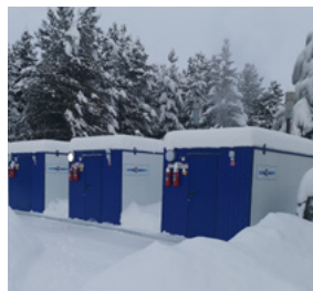
Дизельная электростанция села Ломбовож ХМАО-Югры
