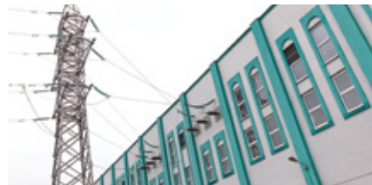
ПС 110 кВ «Университетская»
